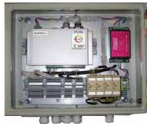
УСПД RTU-325L в шкафу МЕТРОНИКА MC-240
